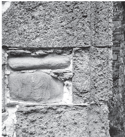
Photo 5 – Porche du réfectoire de l'abbaye de Beauport ; altération météorique du « tuffeau vert » ; moellons érodés en grès roses (cl. L. Chauris, 19 mai 2004)
