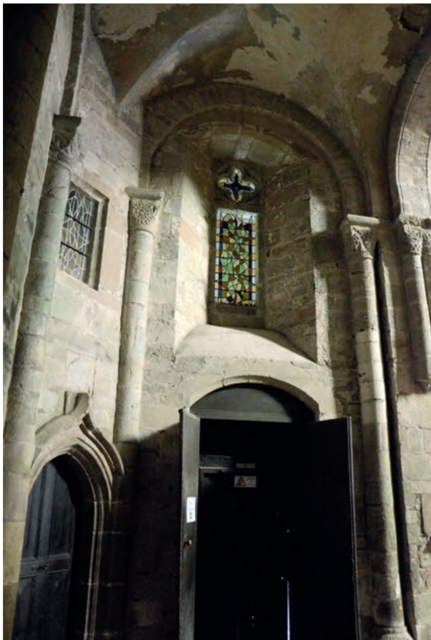
Figure 4 – Tréguier, cathédrale, murs oriental et septentrional du premier niveau de la tour Hastings (cl. A. Ybert)
